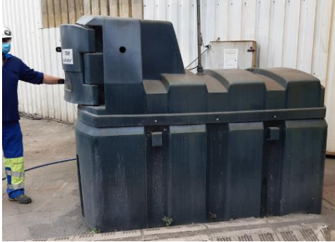
Cuve de gasoil
